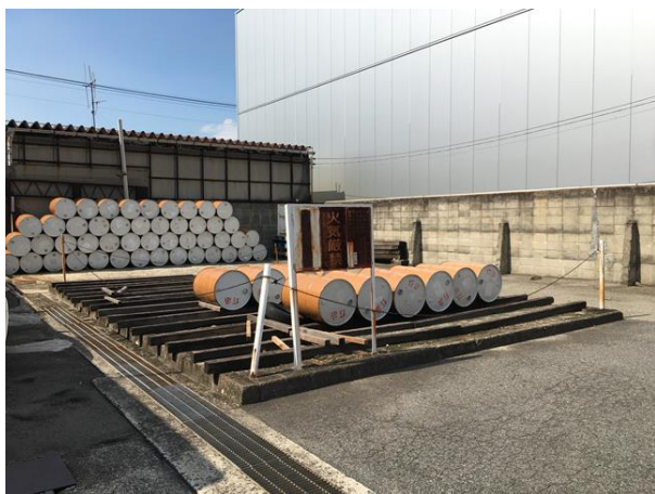
危険物屋外貯蔵所 第4類 3石、4石 48m 2 危険物製造所 メタノールタンク 15KL×1本
